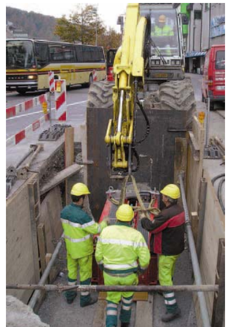
Installatie hydraulische unit
